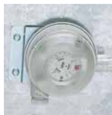
Pressostato colocado no interior da caixa.
